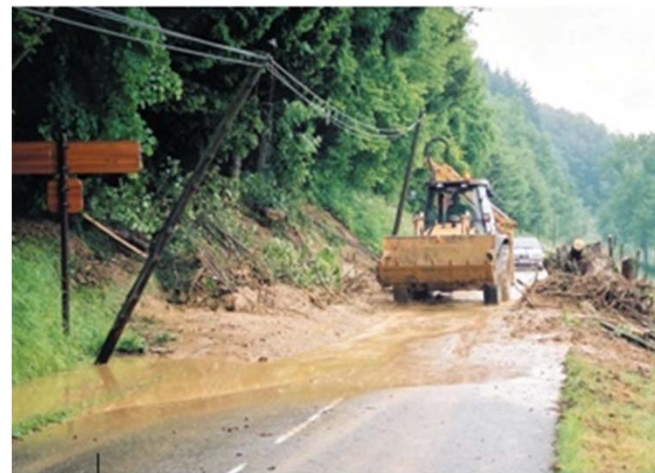
Coulée de boue - Merlas - phase post-urgence : rétablissement des voies de communication - juin 2002
